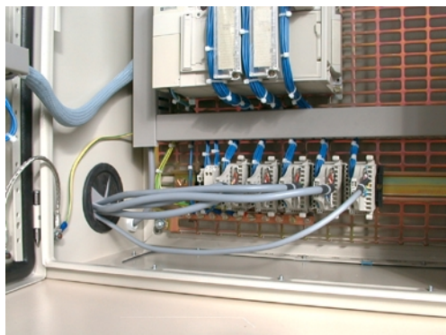
Branchements des câbles et des connecteurs
