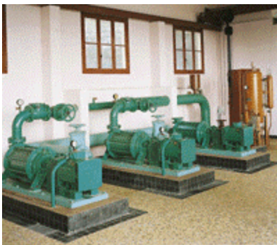
Local technique d'une station de pompage.
